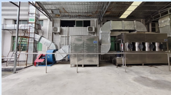
废气处理设施
